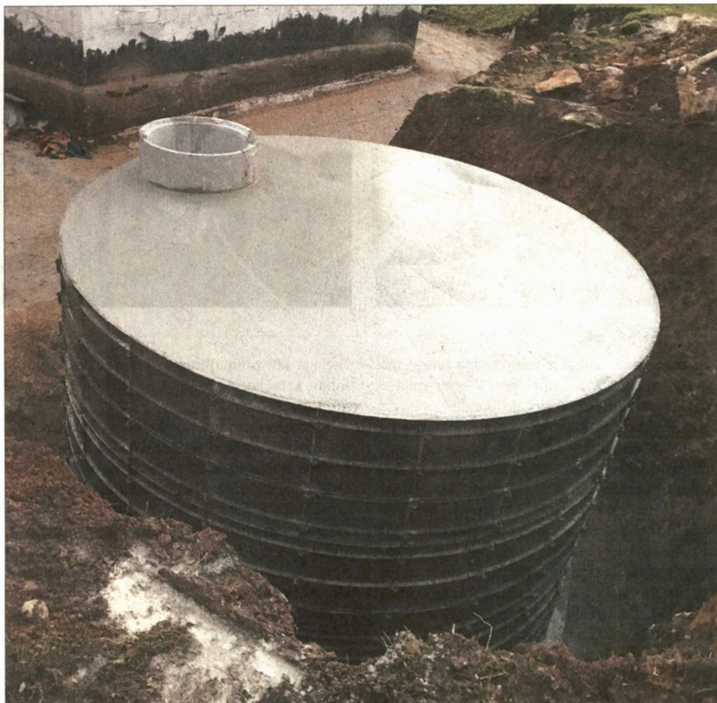
Subvencijo je možno dobiti tudi za izgradnjo zbiralnika za deževnico.
